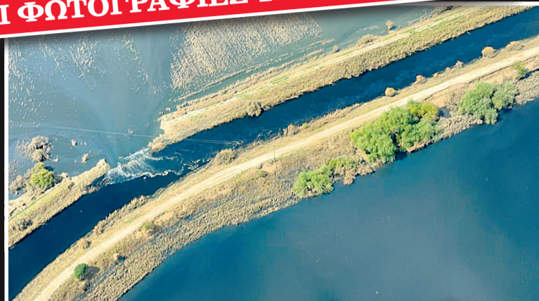
Ανάχωμα που κατέρρευσε στον ποταμό Μέγα στην Καρδίτσα
